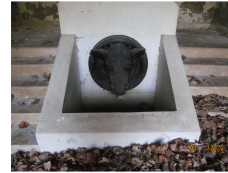
Forrásházban található vas disznófej forrásvíz kifolyó forrásvíz nélkül. (2022)
