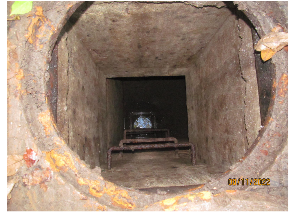
F_3_7914_kép_Műleírás melléklet_zsompban víz
