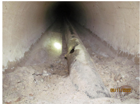
Csővezeték sérült a forrásvíz ezért sem tud eljutni a vas Disznófő kifolyóig. (2022)
