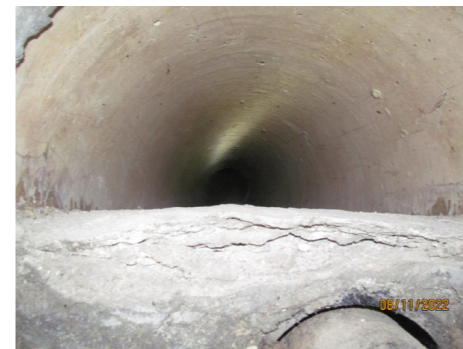
Kibetonozott forrásfoglalás alagút és benne a csővezeték a forrásvízgyűjtő galériáig. (2022)
