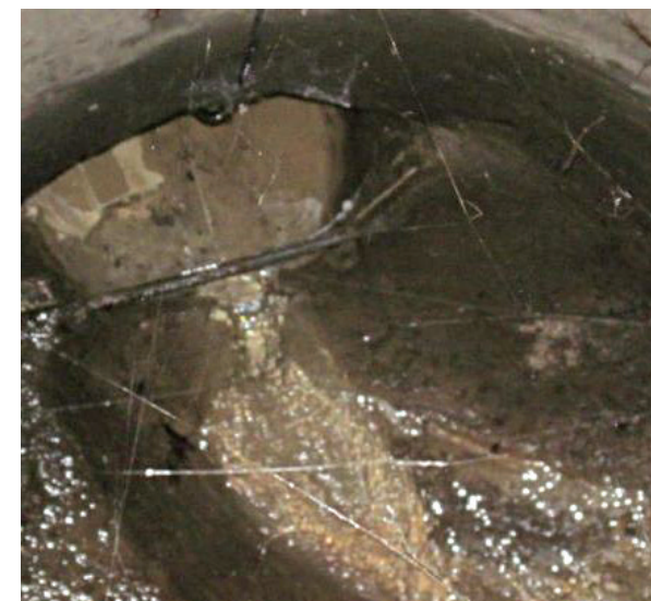
55. kép: Az Ágnes-forrásba bűvár által beépített víz-visszaduzzasztó bukó
